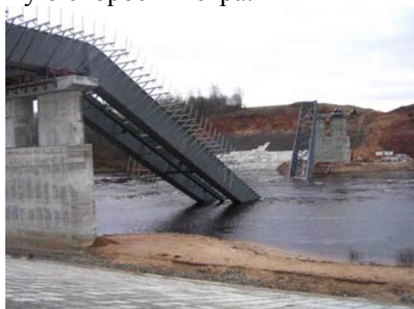
Рис. 3. Обрушение недостроенного моста в Витебске.
