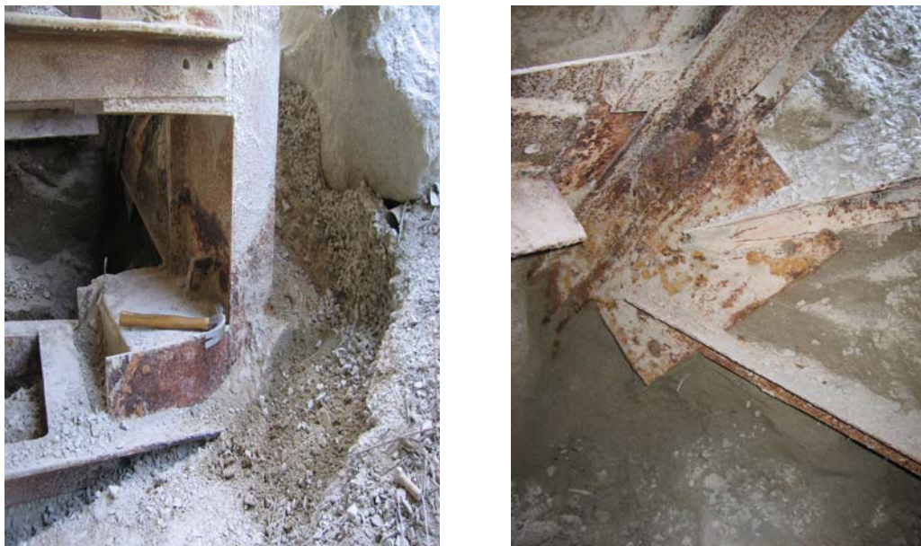
Рис. 2. Коррозия элементов опорных узлов.
